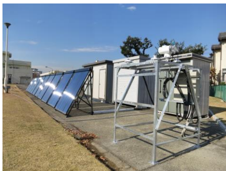
天候観測システムと集熱システム
